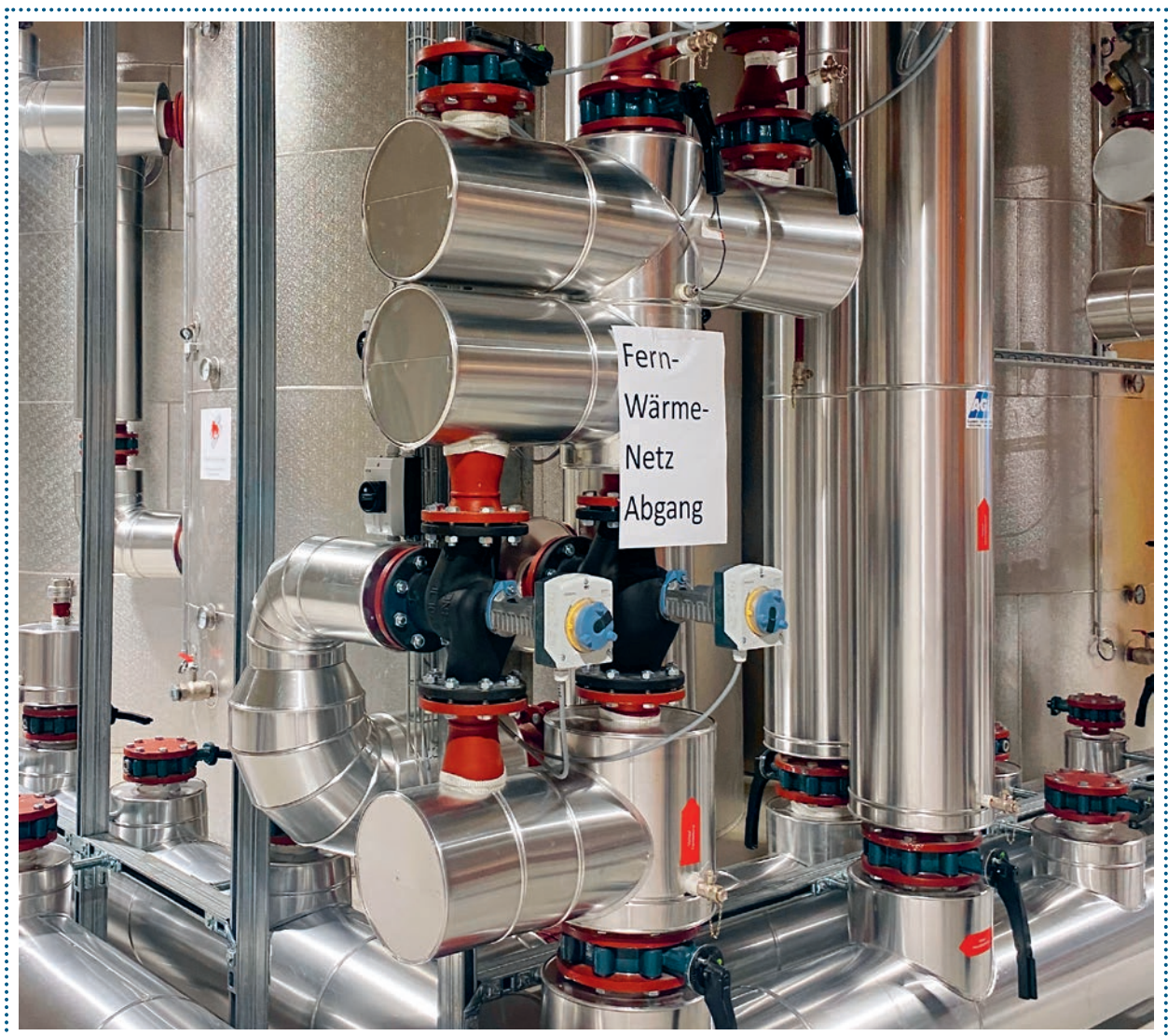
Blick in die Heizzentrale Rain (Foto: Peter Bumbacher)
