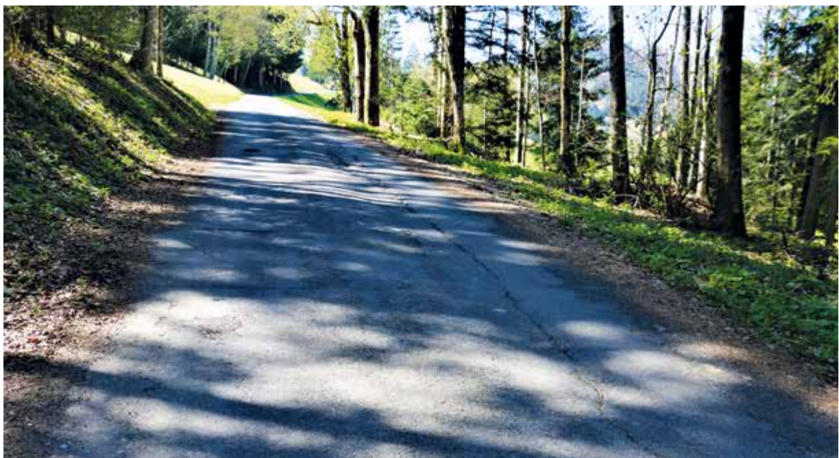
Risse in der Strasse führen zu Unterspülung und Frostschäden
