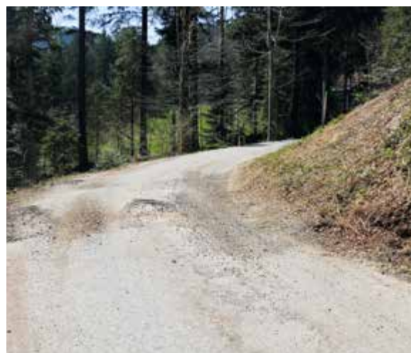
Schlaglöcher durch die starke Beanspruchung der Strasse
