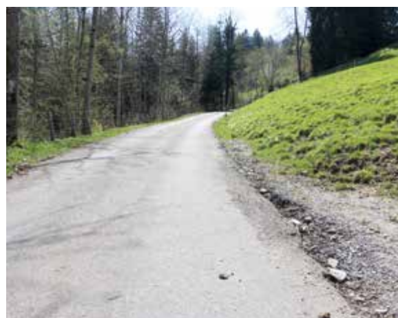
Unkontrollierte Wasserableitung führt zur Unterspülung der Strasse
