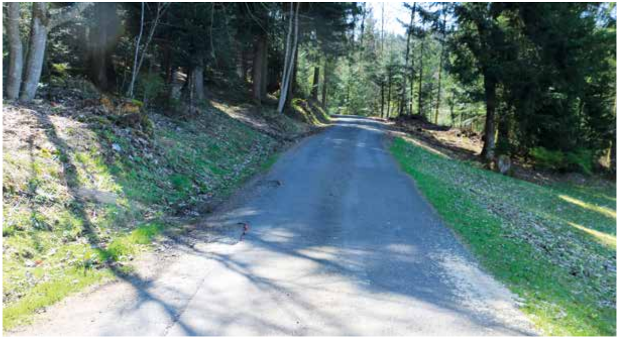
Schlaglöcher durch die starke Beanspruchung der Strasse
